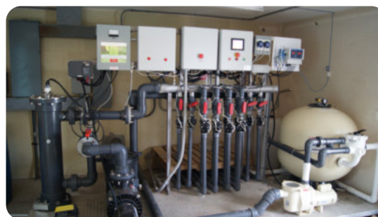
Sistema de recirculación
