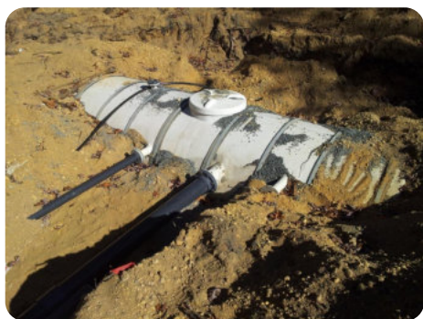
Tanques de almacenamiento
