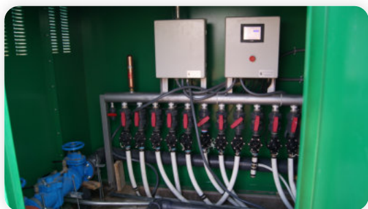
Sistema de drenaje
